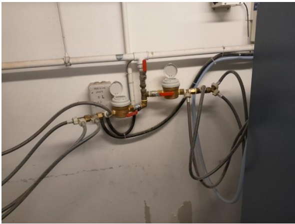
Vue des compteurs d'eau
